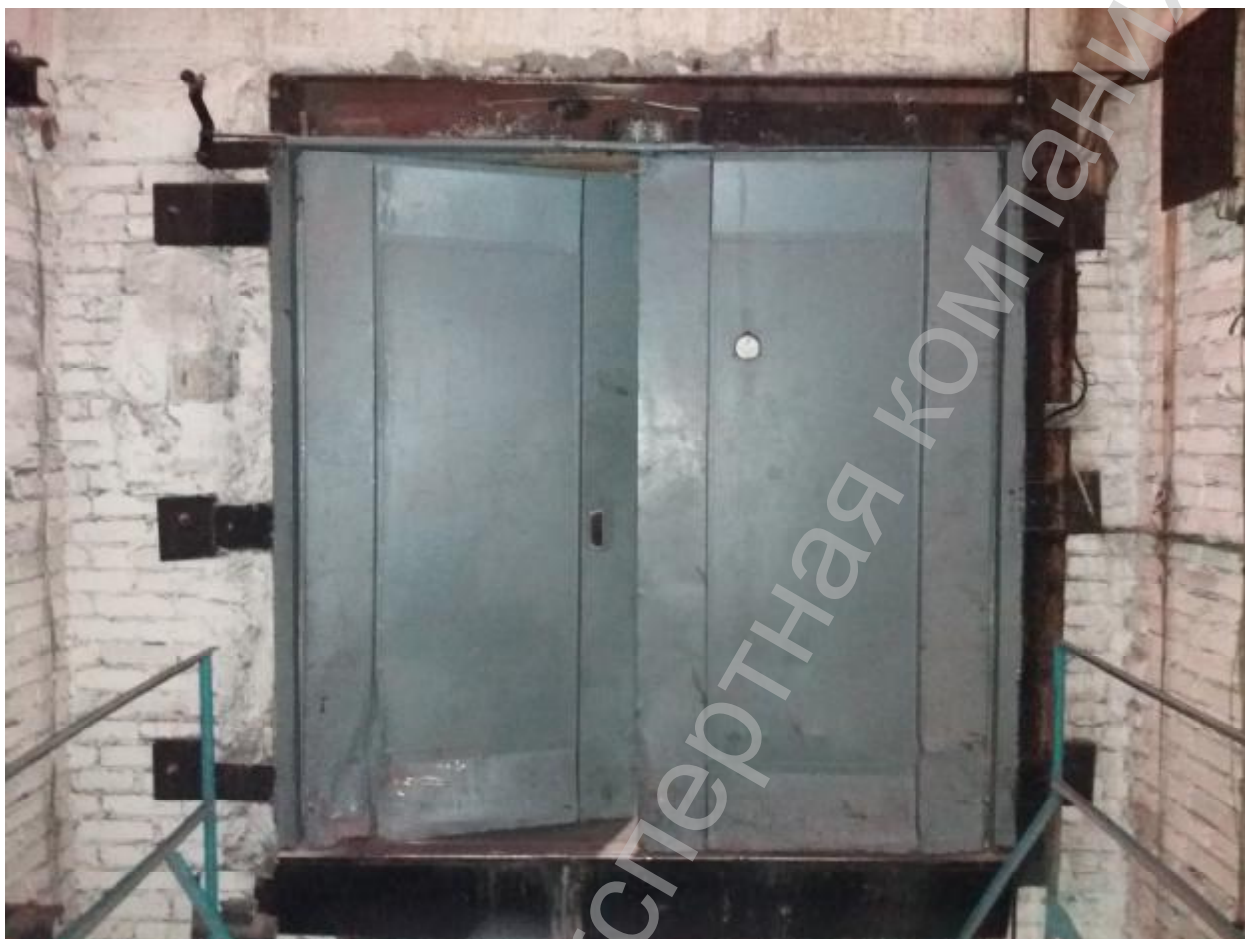
Фотоиллюстрация 8. Шахта лифта. Двери шахты лифта на 2 остановке.
