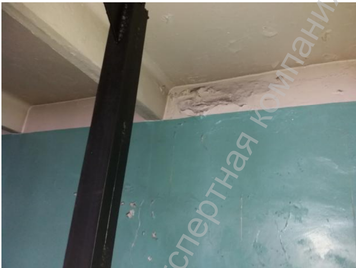
Фотоиллюстрация 14. Машинное помещение лифта. Частичное повреждение покрытия стен и потолка в МП
