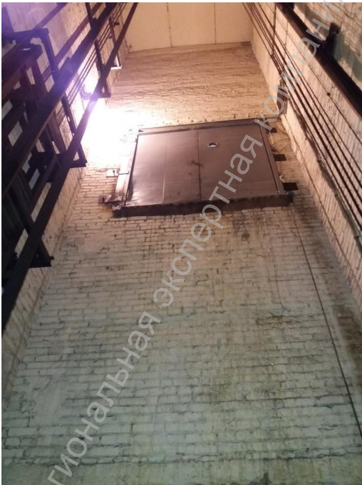
Фотоиллюстрация 7. Шахта лифта. Двери шахты лифта на 3 остановке.
