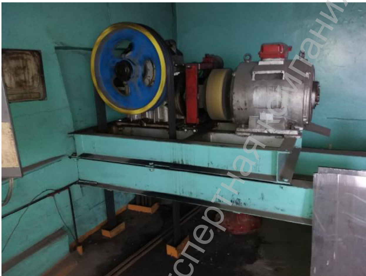
Фотоиллюстрация 18. Лебедка подлежащего замене лифта.
