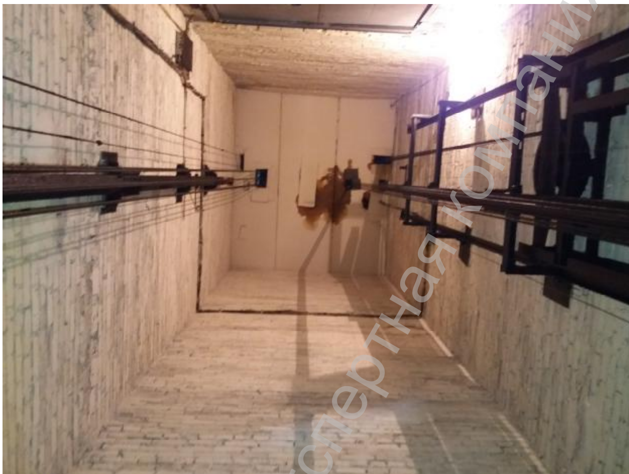
Фотоиллюстрация 6. Шахта лифта. Загрязнено маслом верхнее перекрытие шахты лифта.
